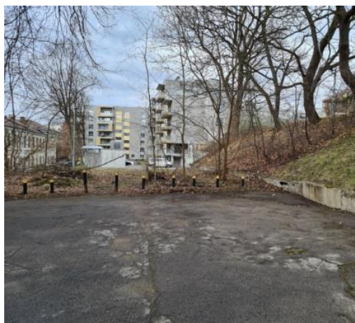
Pav. 5. Asfaltinėje dangoje išaugę medeliai
