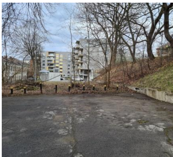
Pav. 7. Asfaltinėje dangoje išaugę medeliai
